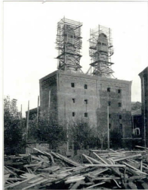
Выполнено для Аси. О-ва Хавонинского завода в Москве. Железобетонные вытяжные трубы для новой соаодовни.
